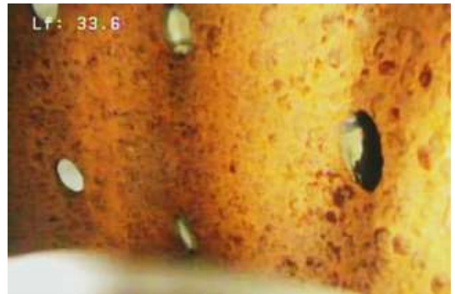
Crépines ouvertes et craie visible à travers les crépines sur F3 à 33.6m - Diagnostic IDEES EAUX le 31/01/2024
